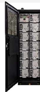
不斷電系統 UPS ESS
